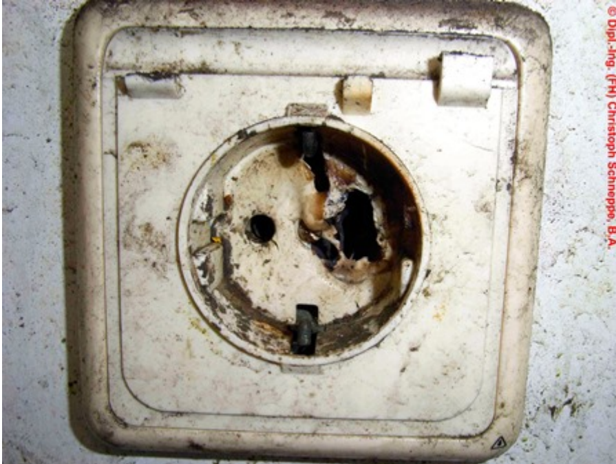
Thermisch beschädigte Steckdose (Bildquelle: Dipl.-Ing. (FH) Christoph Schneppe, B.A.)
