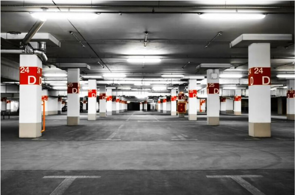
Brandmeldeeinrichtungen in Tiefgaragen sind von Sachverständigen zu prüfen (Bildquelle: Lanski/iStock/Getty Images)
