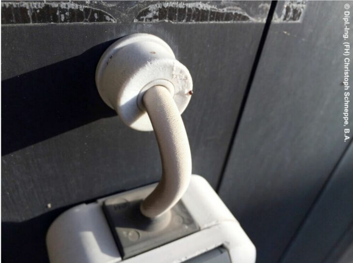
Ungeschützt gegen direkte Sonneinstrahlung verlegte NYM-Leitung
