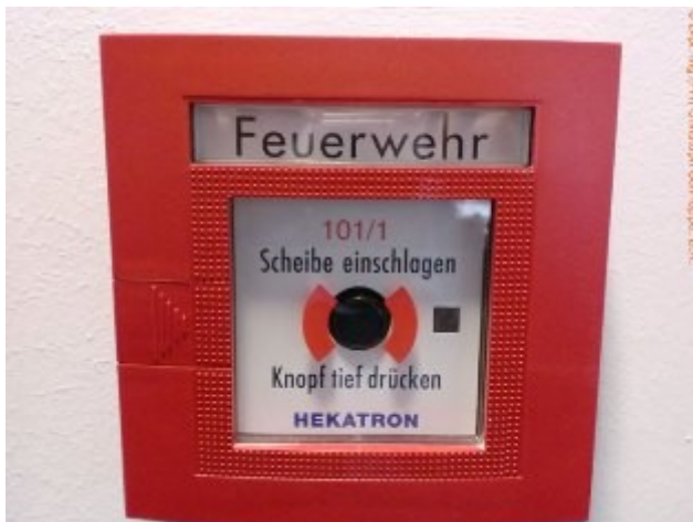
Nicht automatischer Brandmelder (DKM)
