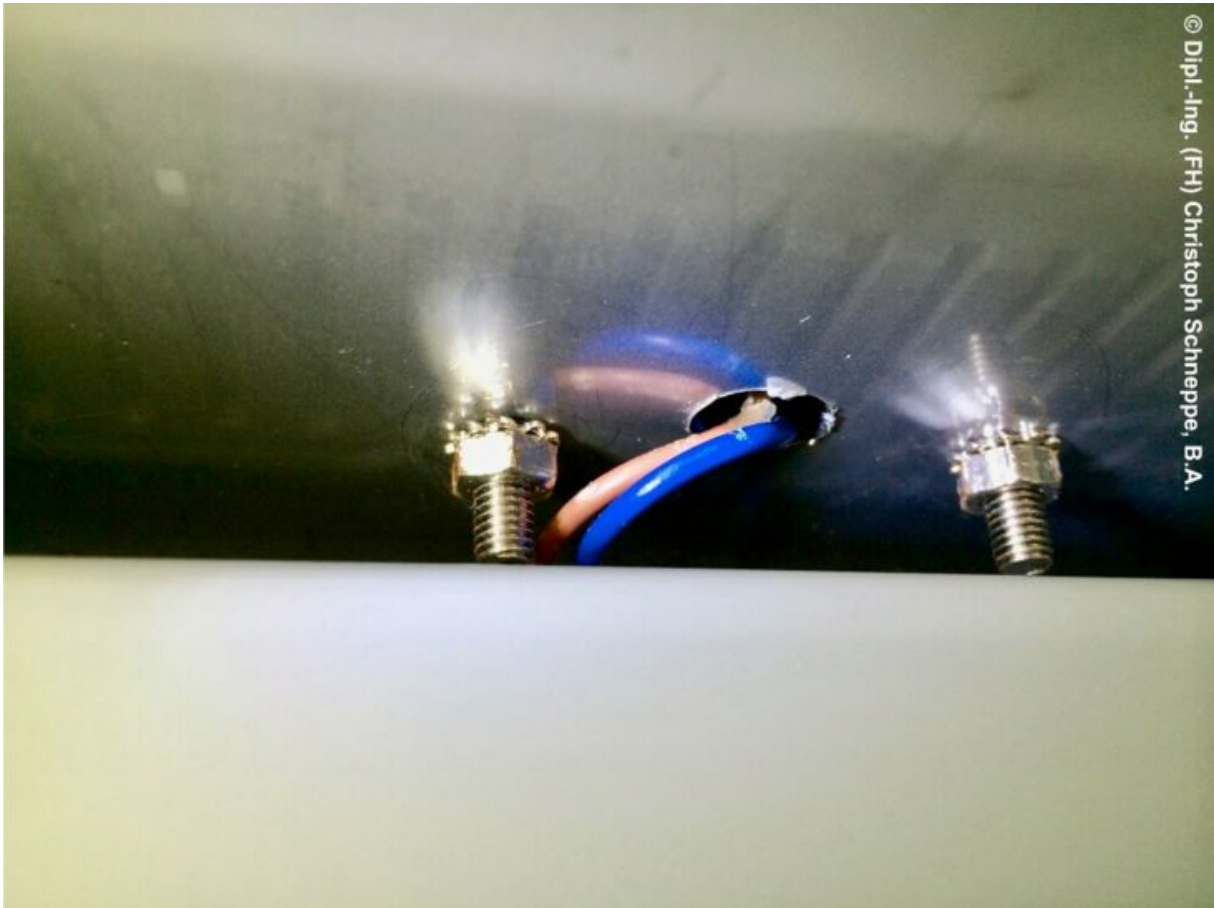
Basisisolierte Leitungsadern ohne ausreichenden Kantenschutz
