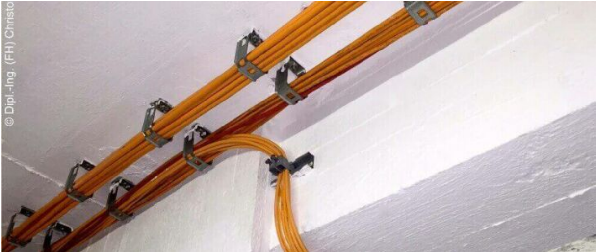
Leitungsanlage mit integriertem Funktionserhalt (Bildquelle: Dipl.-Ing. (FH) Christoph Schneppe, B.A.)
